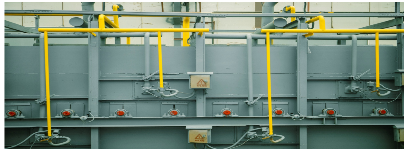
天然气热处理炉
